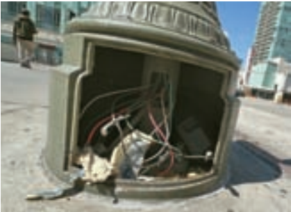
철제 보호관넬이 없어진 가로등 하단 부분. LA 한인타운 윌셔 블러바드와 올림픽 블러바드의 가로등 수십 개가 구리선 절도로 하단 부분이 드러나 있다. 김상진 기자
