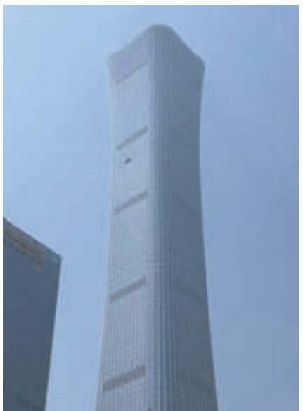
28일 낮 중국 베이징 중심업무지구(CBD)의 초고층 빌딩 시틱타워(중국명 중신빌딩) 외벽에 경비행기 충돌로 생긴 흔적이 남아 있다. [베이징-연합뉴스]
