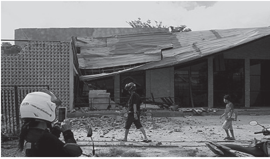
인도네시아 팔루 인근서 발생한 지진으로 파손된 건물
